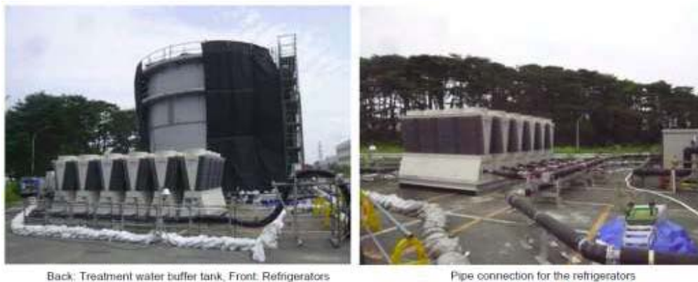
شکل ۷. تصاویر یونیت‌های سردسازی که برای آبی که به مخزن بافر وارد می‌شود به تازگی نصب شده است
