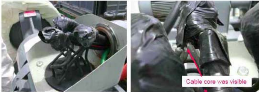
شکل ۱۷. ترمینال پمپ قبل از تعمیر
