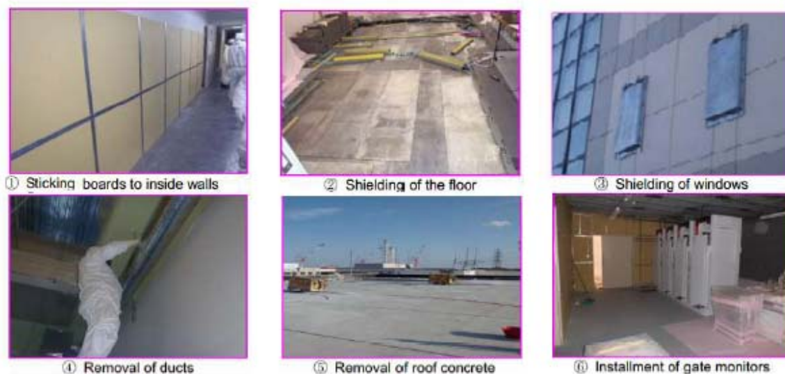
شکل ۱۱. اقدامات متقابل انجام شده در ساختمان ایزوله مقاوم در برابر زلزله
