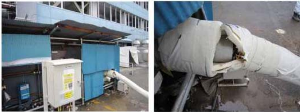
شکل ۱۲. تصاویر نشت آب نزدیک اتاق پمپ انتقال آب تصفیه شده
