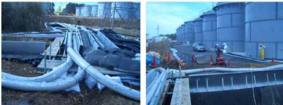
شکل ۲۹. لوله‌هایی که آب مخزن نگهداری آب از آن نشت می‌کرد
