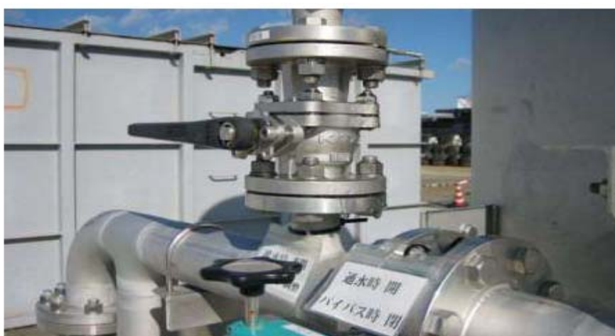
شکل ۱۰. نشتی مشخص شده در ۲۸ ژانویه در قسمت جاذب مواد معدنی دستگاه تغلیظ تبخیری
