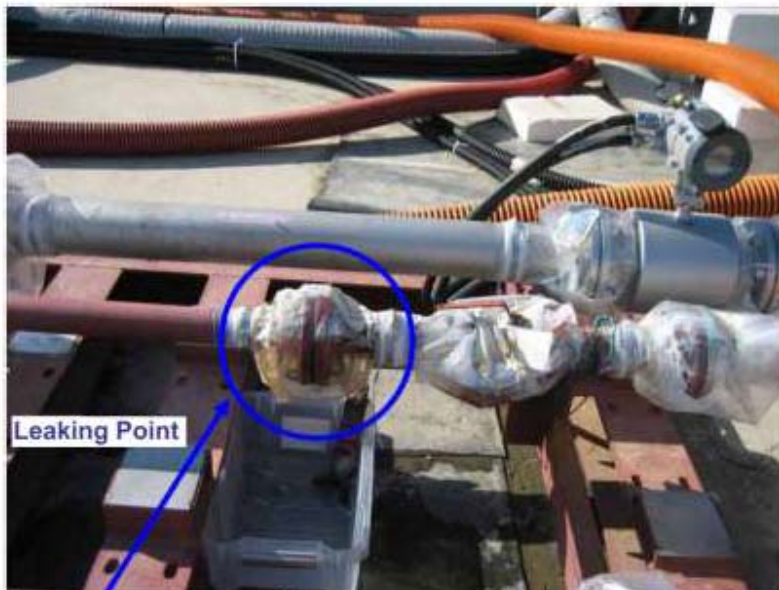
شکل ۱۱. نشتی مشخص شده در ۲۸ ژانویه از لوله کشی جریان کم پمپ پشتیبان اسمز معکوس پسمان
