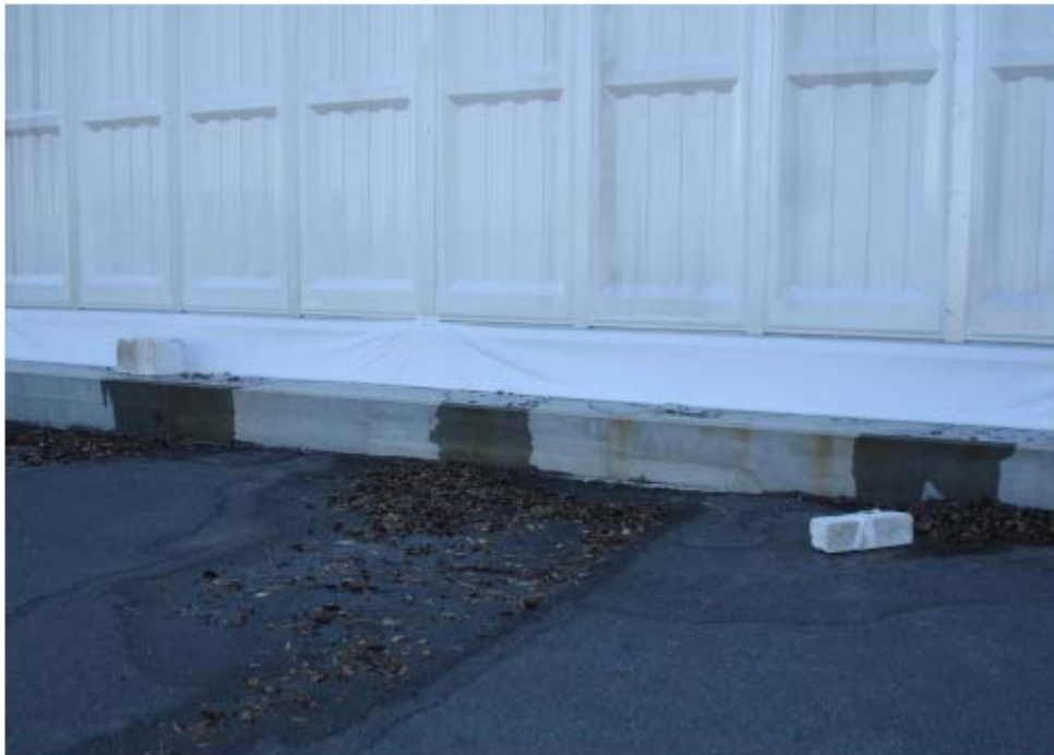
شکل ۴. محلی که آب نشت یافته از دستگاه تغلیظ تبخیری از ساختمان خارج می شود
