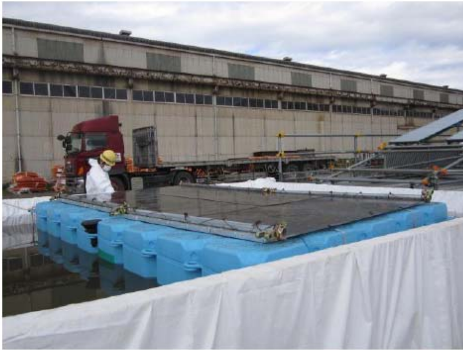
شکل ۷. تصویر مدلی به اندازه طبیعی و کامل از پوشش حوضچه سوخت مصرف شده یونیت ۴
