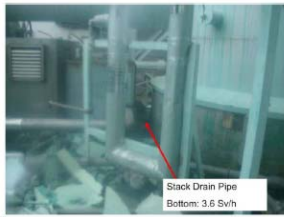
شکل ۱۴. مکان با آهنگ دز ۳/۶ سیورت بر ساعت در قسمت تحتانی لوله‌ای که برای خارج کردن آب باران از دودکش است
