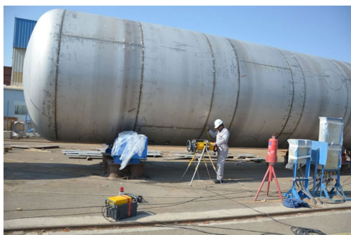
(ب) آزمون غیرمخرب پرتونگاری از یک مخزن. [برگرفته از International inspection centre co (۱۴۰۰/۰۲/۰۹) به‌نشانی
