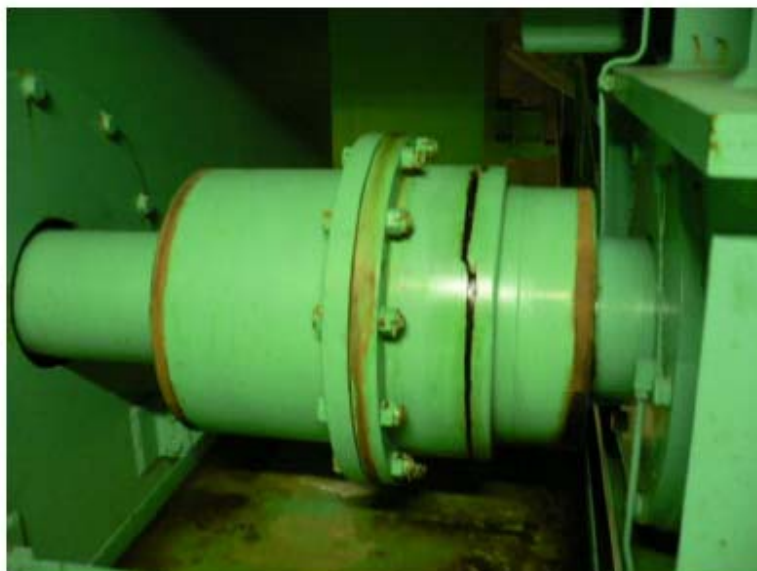
شکل ۱۱. شکاف در محل اتصال محور جرثقیل حوضچه مشترک سوخت مصرف شده
